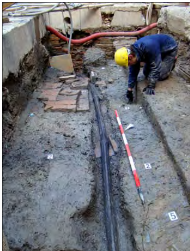
Fig. 1. Modena, Via Amendola. Condotto in laterizi di acquedotto per l'approvvigionamento urbano di Mutina. Modena, Viale Amendola, scavo 2010.
